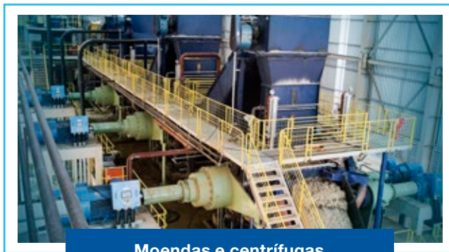
Moendas e centrífugas
